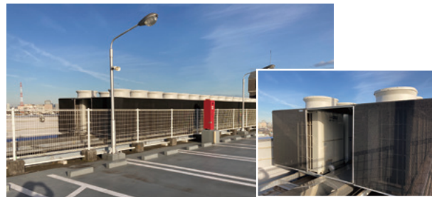
エアコン室外機に設置した遮熱ネット
