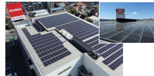
店舗屋上に設置した太陽光パネル
